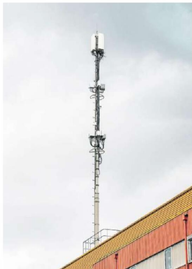
Eine 5G-Antenne in Alpnach.
